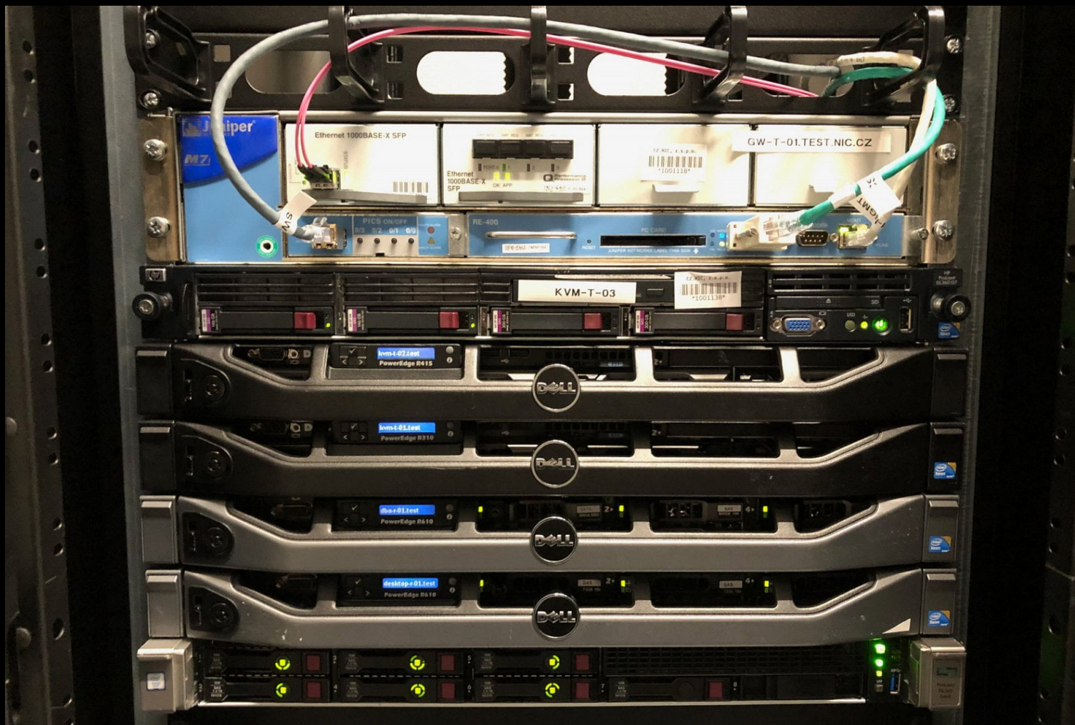
servery v racku v datacentru nic.cz (nahore router) / foto root.cz
